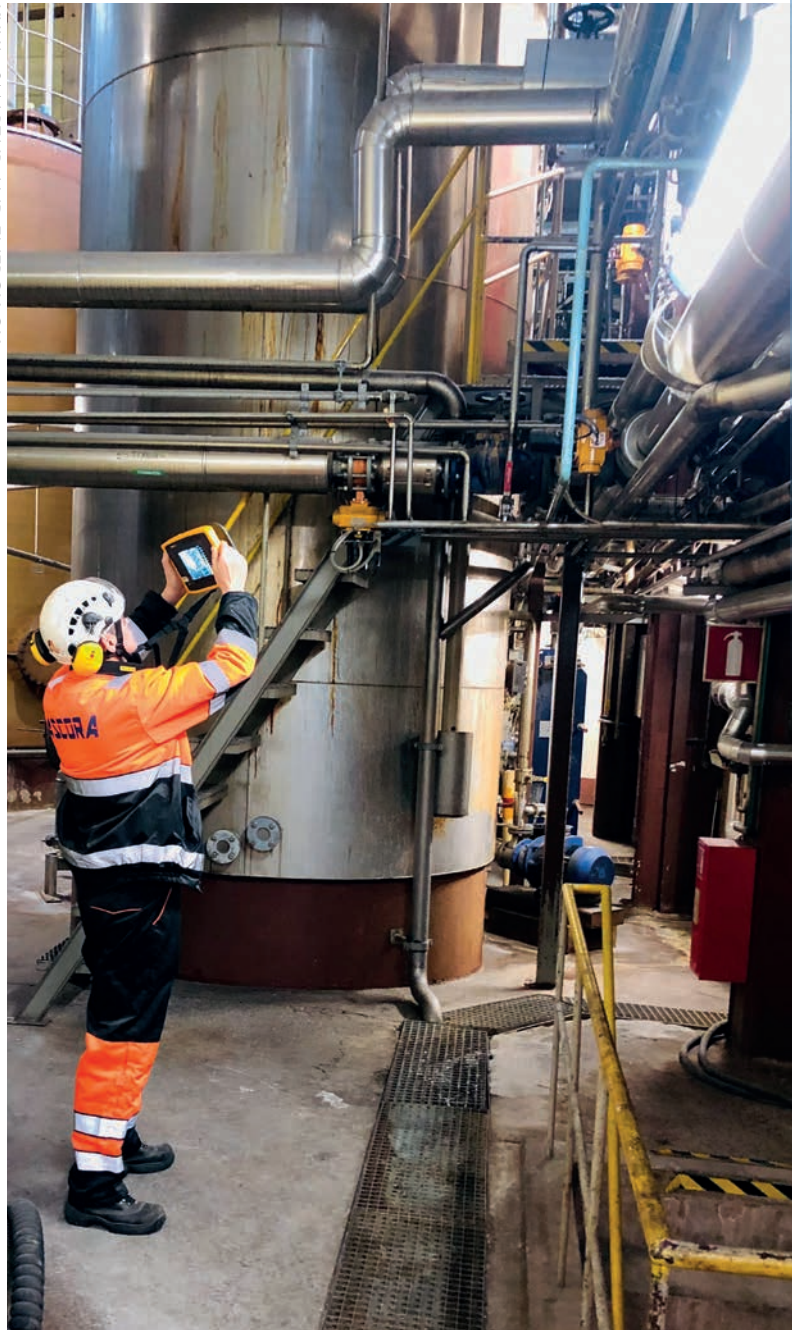
Pekka Sirkkola suorittamassa paineilmajärjestelmän vuotokuvausta.
