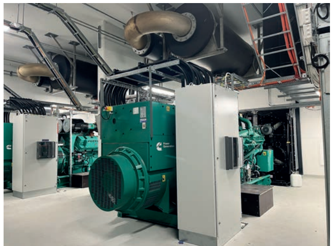
Varavoimakoneet asennettuna varavoimahuoneeseen.
