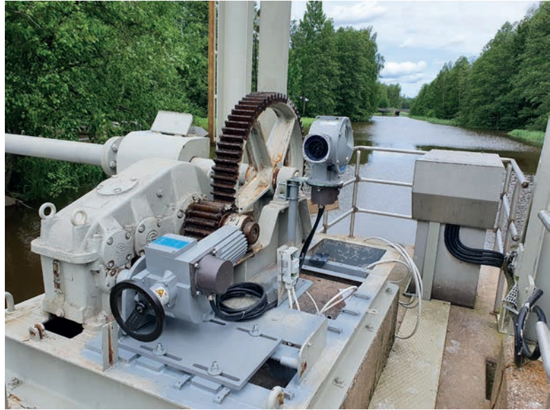
AUMA SEVEN ohjaamassa patoluukua Hiidenvedellä.
