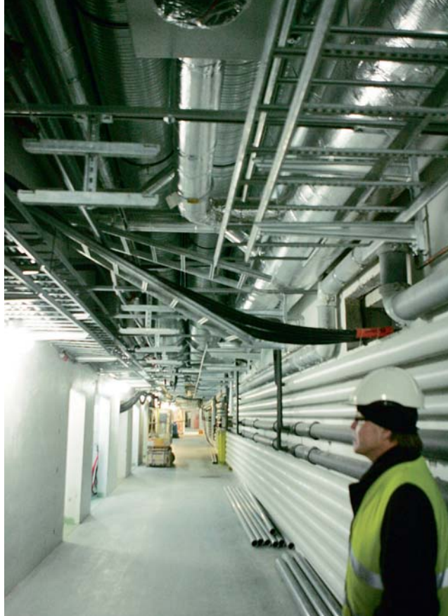
Yhdistävänä tekijänä Musiikkitalossa on läpi talon ulottuva talotekniikkakäytävä.
