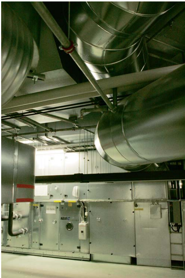
Ilmastointiputket hallitsevat talotekniikkaa.
