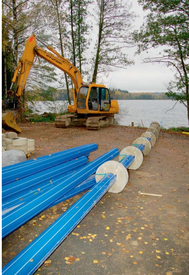
Kisakallion urheiluopiston rakennuksiin saadaan lämmitys- ja jäähdytysenergiaa Lohjanjärveen upotetuista vesistölämpöputkistoista.
