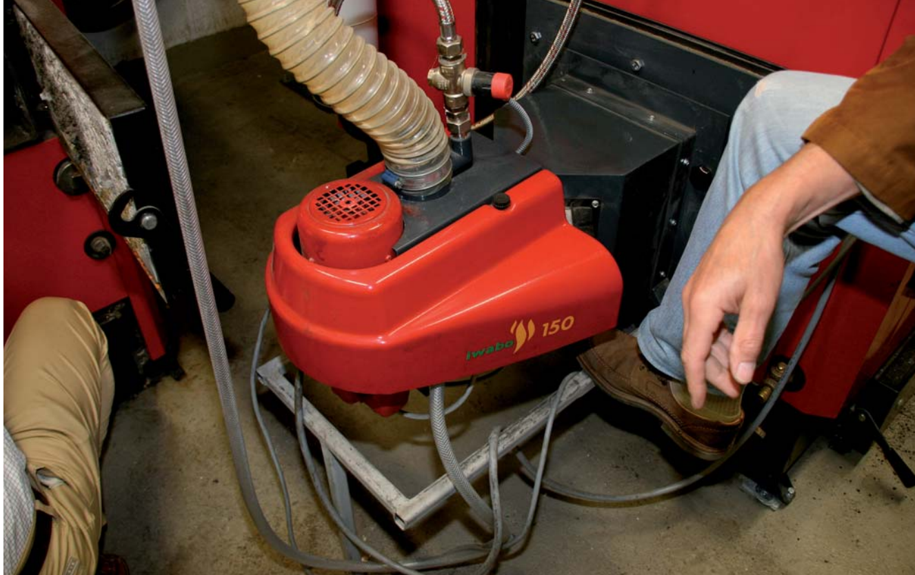
Pellettilämpö tuotetaan kahdessa kattilassa tehokkaalla pellettipolttimella lämmön riittäessä aina, riippumatta ulkolämpötilasta.
