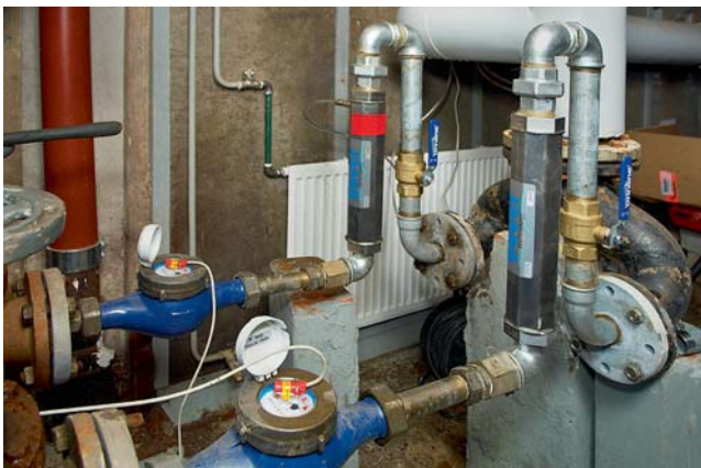
Bauer-vedenkäsittelylaitteet asennettuna vesimittareiden jälkeen.
