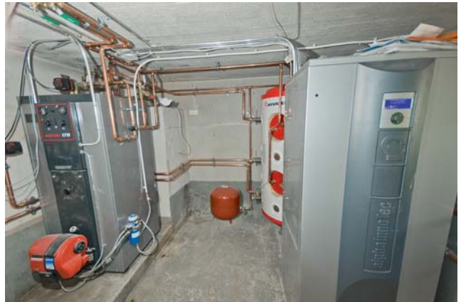
Keravalla saneeratun kiinteistön uusia laitteita: vasemmalla öljykattila, oikealla maalämpöpumppu ja sen takana energiavaraaja.
