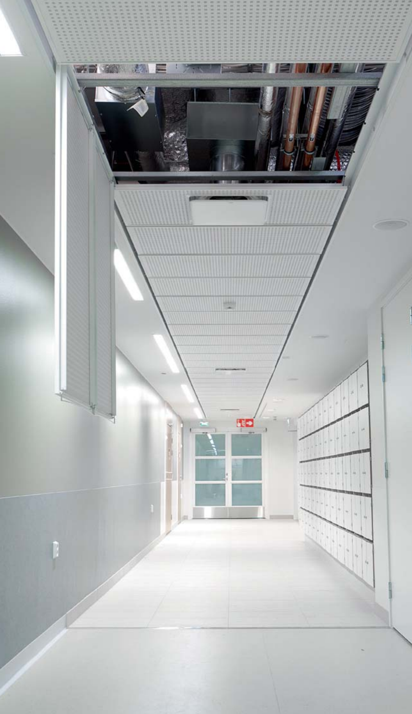
Gyptone Trap Quattro 20 käytäväkatto.
