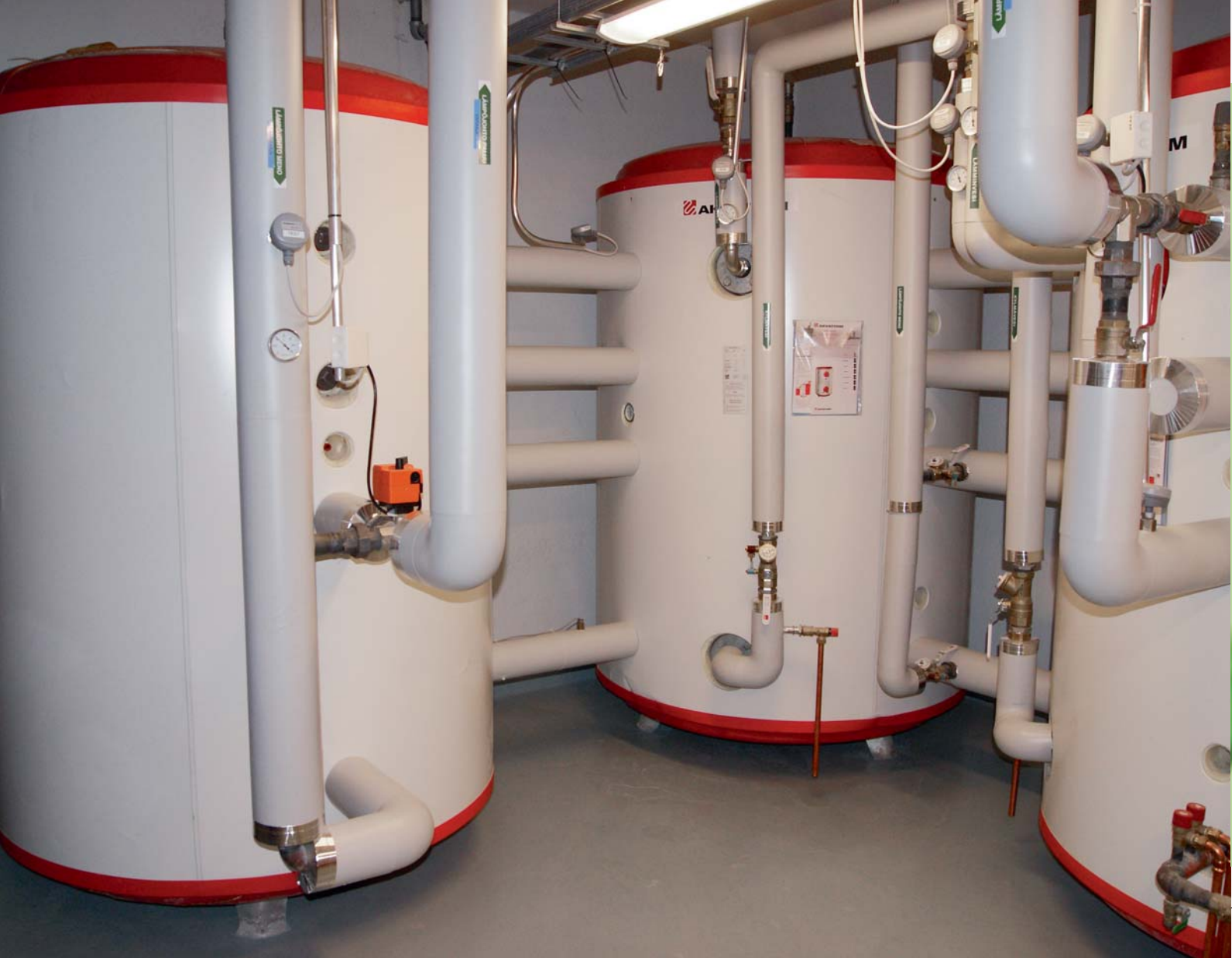
Jampankaari 4:n talon aurinkolämpöjärjestelmä on kytketty kolmeen 2 000 litran vesivaraajaan.
