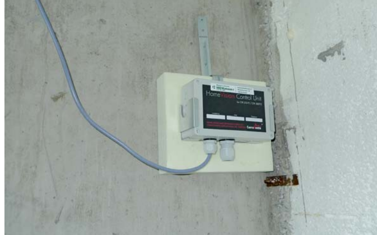
Keskusyksikkö tarkkailee ryömintätilassa vallitsevan ilmatilan kosteutta.
