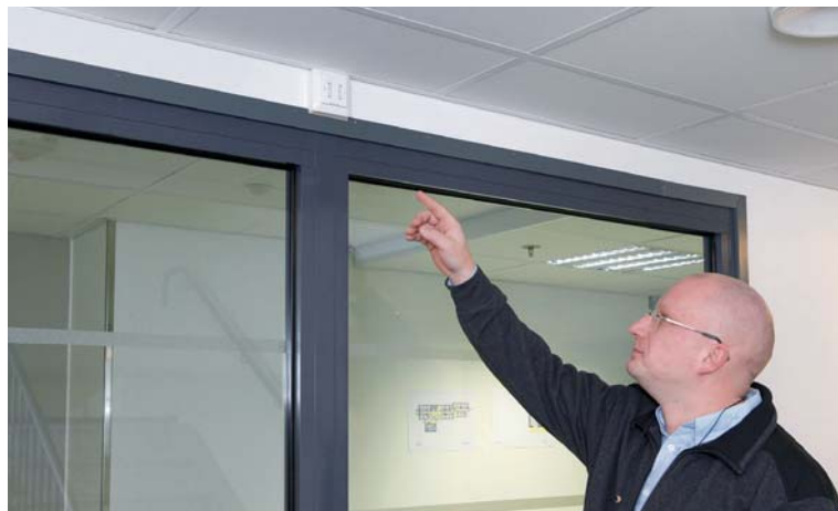
Porraskäytävien ohjaus toteutettiin Extronin akustisilla tunnistimilla. Kohteen sähkösuunnittelijan Sähkö Pietikäinen Oy:n Jarmo Pietikäinen osoittaa mikrofonia AD-260.
