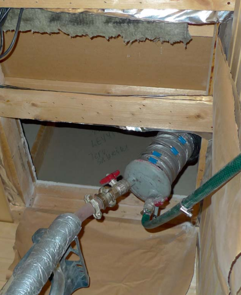
Höyryä syötetään huoneistokohtaisen saunatilan ilmanvaihtohormiin Katajan talossa. Kondenssivesi poistetaan pienemmän letkun kautta.
