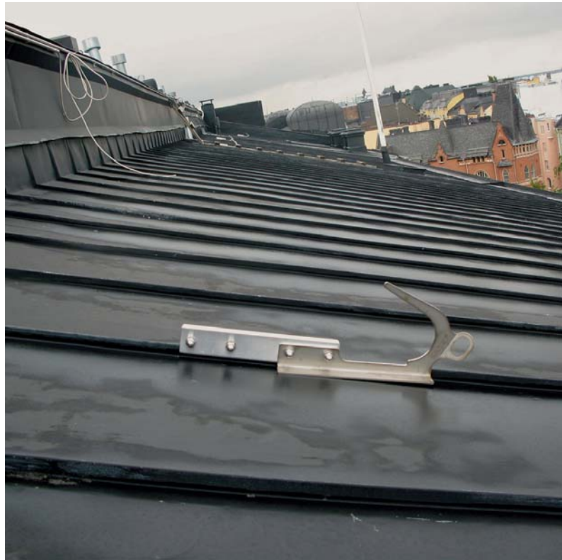
LUX-top® SDH-Falz / TurvaYkkönen ankkurointipisteitä, asennettuna As Oy:n katolle Helsingin Katajanokalla.
