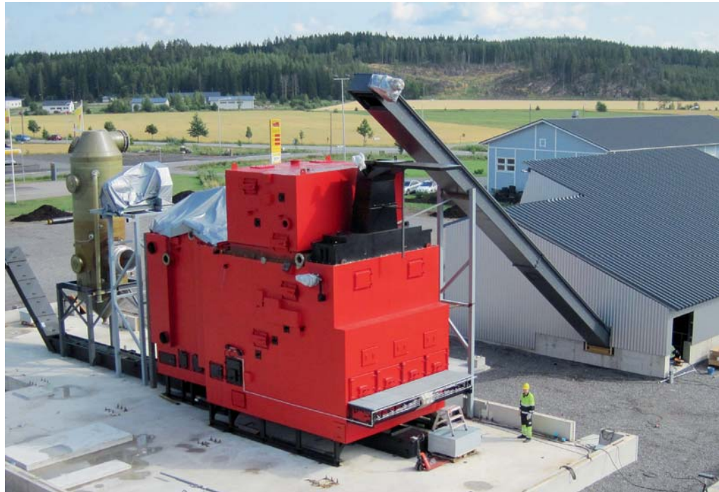
Someron lämpökeskus, Laka Y – 7 MW ja polttoainevarasto 800 m 3 .
