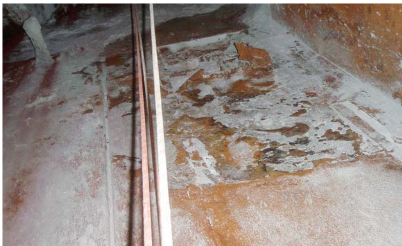
Kuvassa näkyy alue, jossa pelti on syöpynyt pois ja eriste on näkyvissä. Vanhankin kanavan korjaaminen on varteenotettava vaihtoehto koko kanavan uusimiselle.
