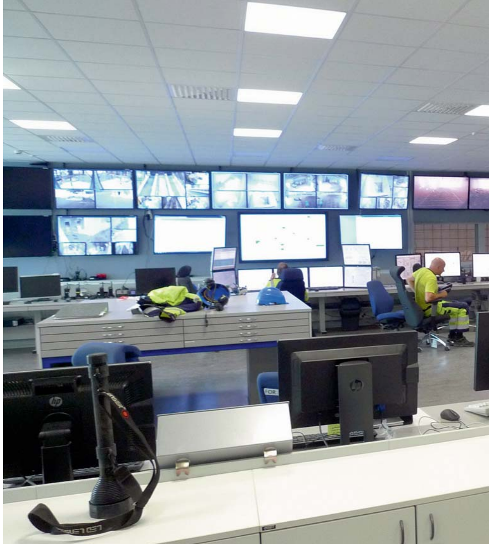
Laitoksen valvomossa seurataan ja ohjataan polttoprosessia.
