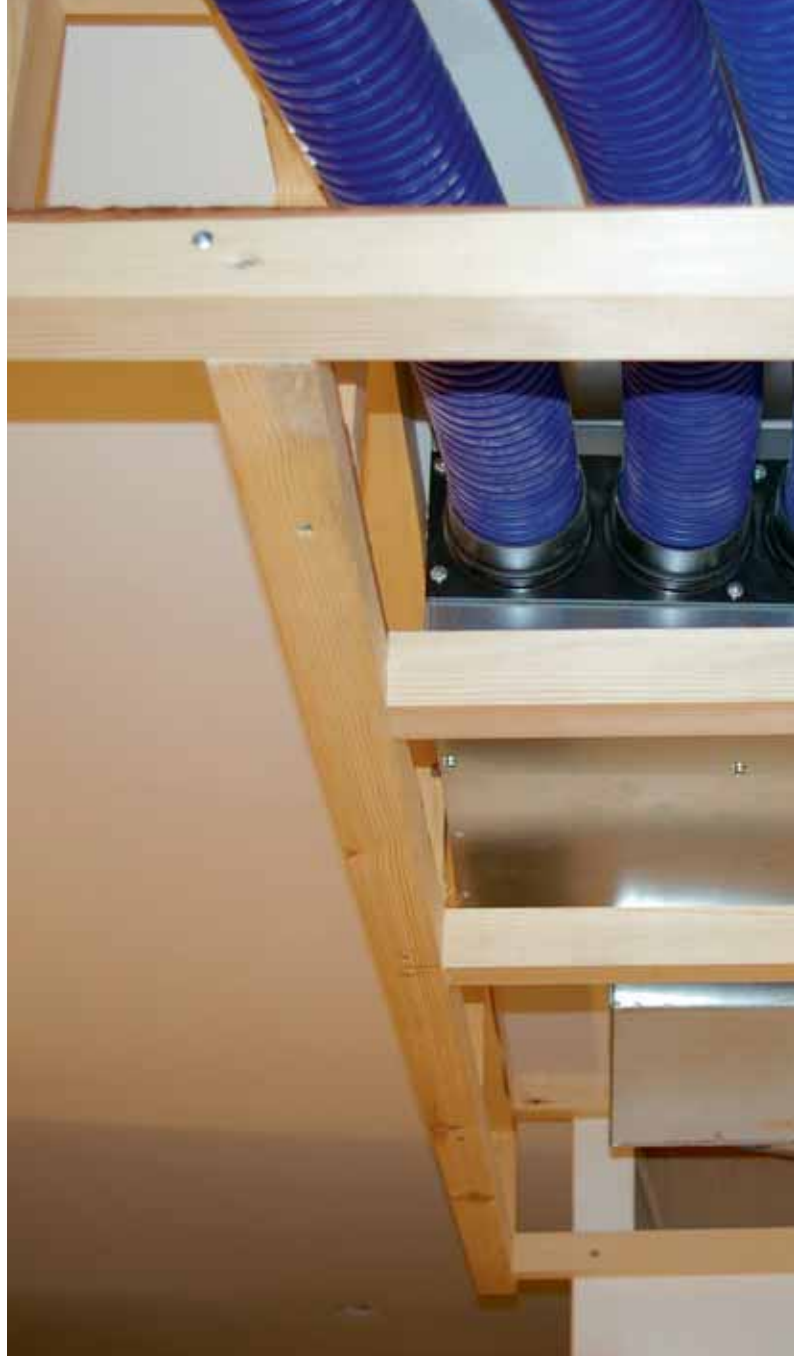
Huoneistokohtaisen ilmanvaihdon rakentaminen vanhaankin asuntoon onnistuu ilman suuria rakennustöitä, koska kanavat voidaan koteloida.
