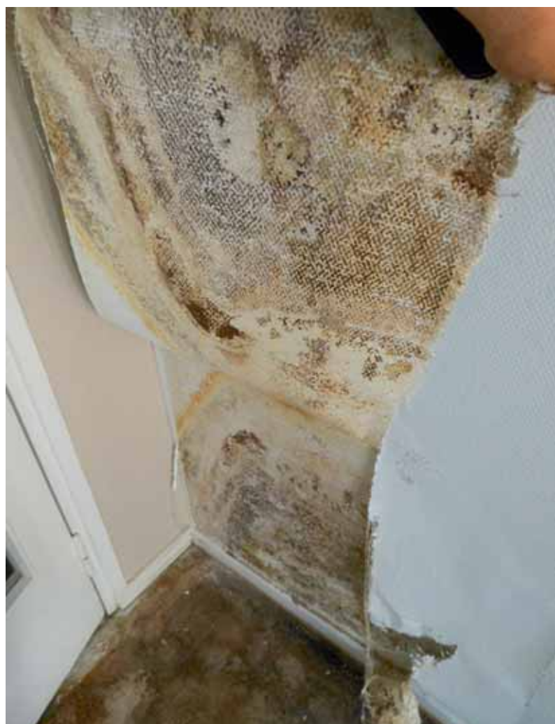
KUVA: VARSINAIS-SUOMEN KIINTEISTÖKUIVAUS OY
