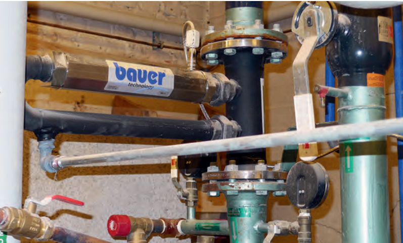
Kustaankadulla Bauerin vedenkäsittelylaitteisto asennettuna lämmitysverkostoon.
