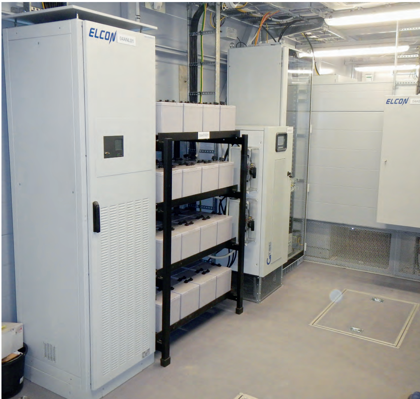
110VDC järjestelmä ja AC-UPS akustoineen ja jakelukaappeineen asennettuna sähköasemalla Suomessa.
