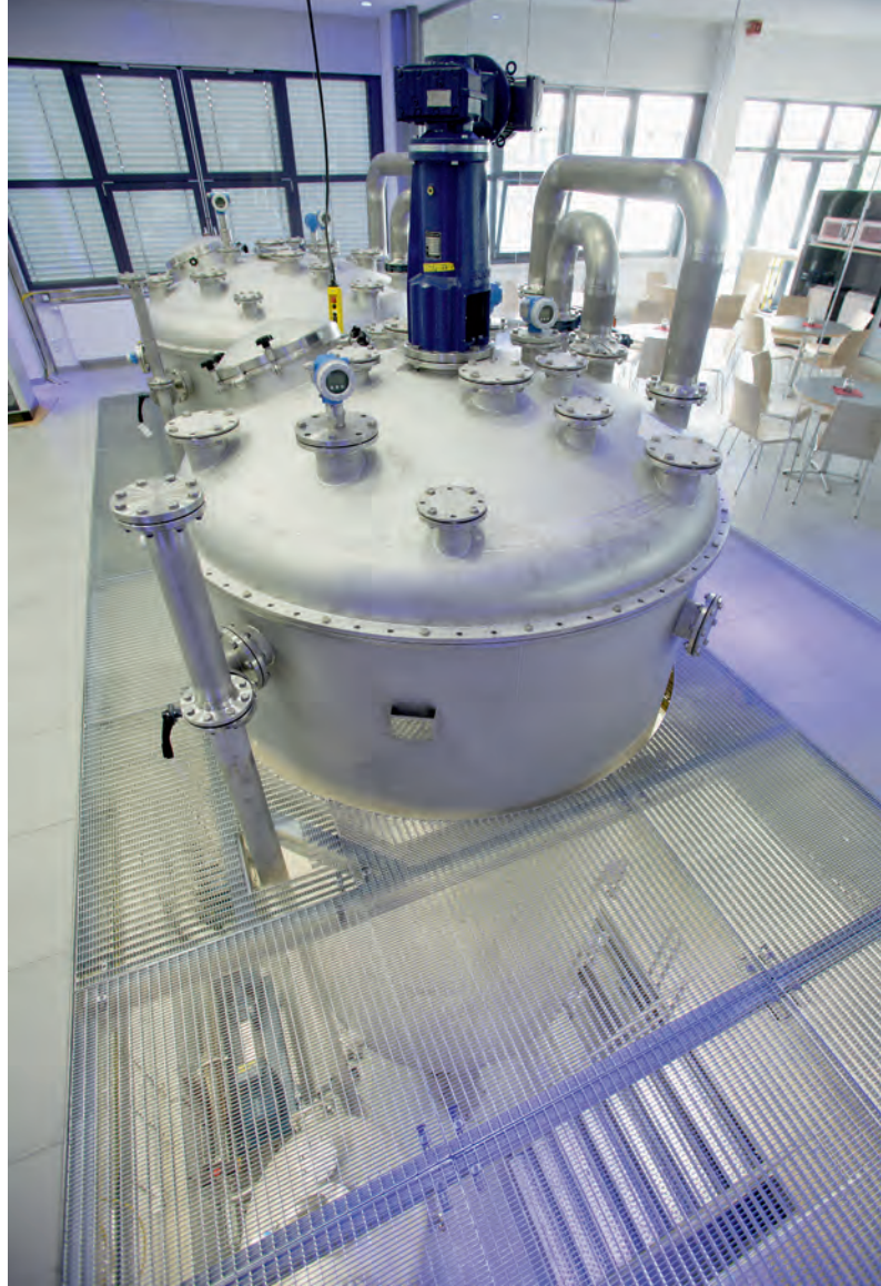
Endress+Hauserin korkean teknologian tekstikeskus Maulburgissa. Tehtaalla valmistetaan yhtiön Euroopan markkinoiden pinta- ja paineinstrumentit.
