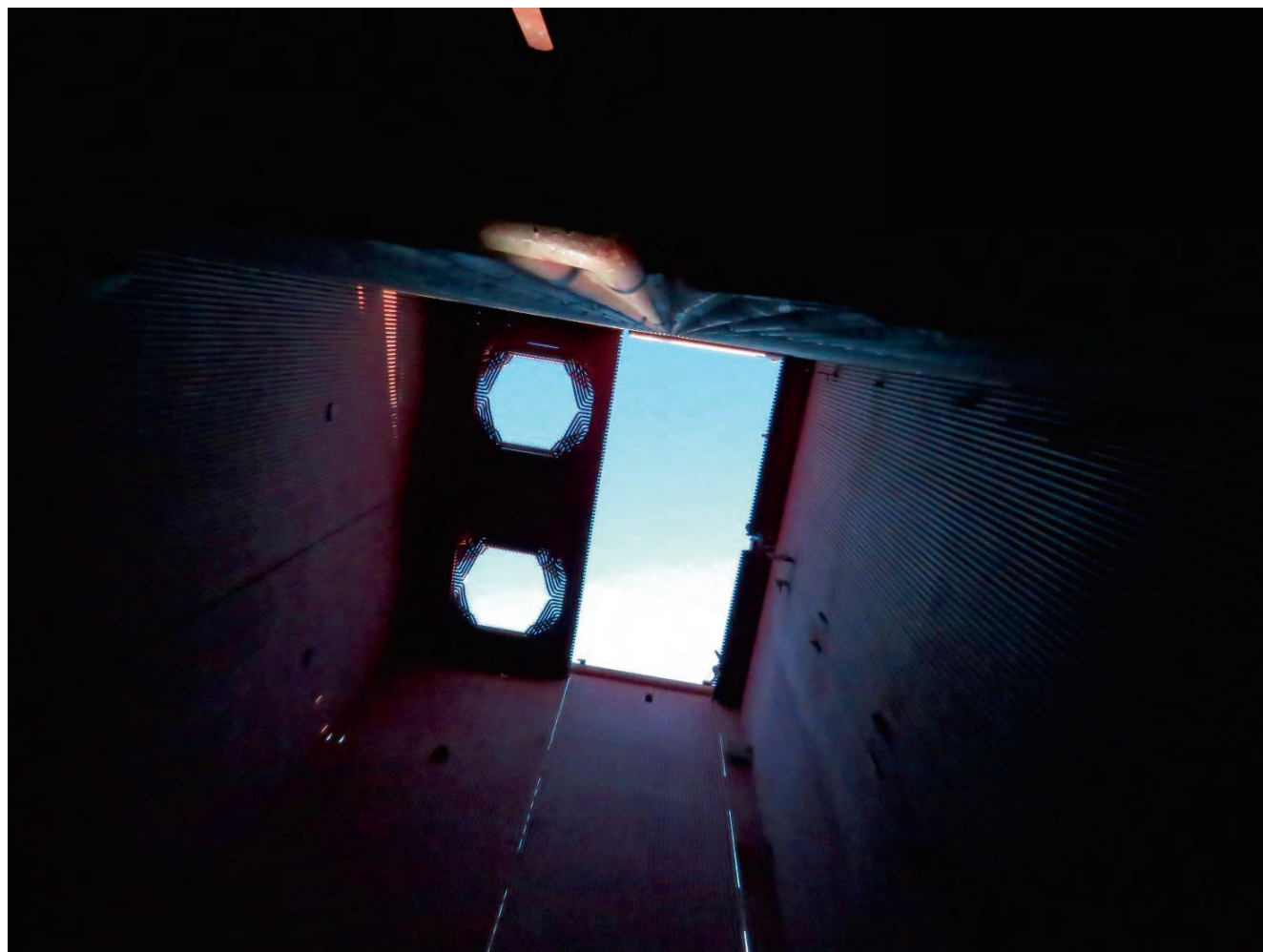
90 MW kattilan tulipesä – 2 poltinaukkoa paikoillaan.
