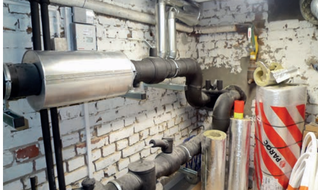
Kaukojäähdytyksen liitäntäpiste kellarissa.
