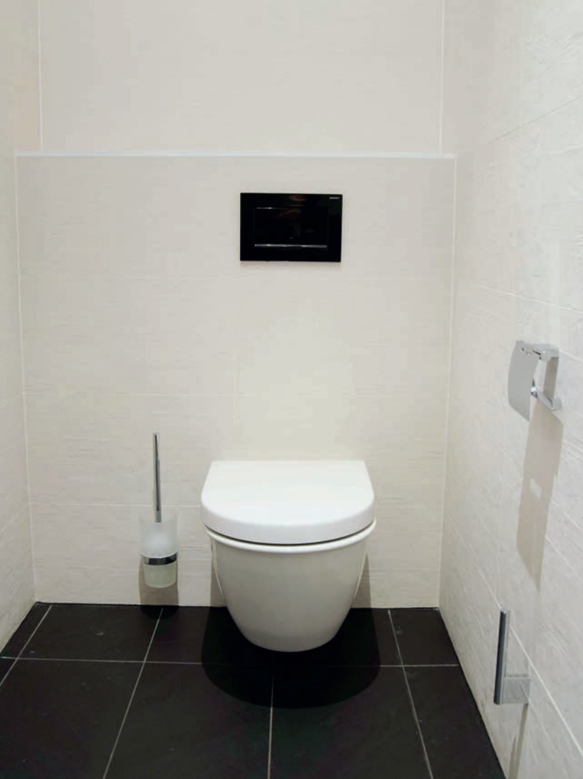
Ala-aulan yleisten WC-tilojen seinä-WC-istuinten asennuksessa on käytetty Geberitin Duofix Sigma -asennuselementtejä. Musta Sigma30 -huuhtelupainike sopii hienosti WC:n tyyliin.
