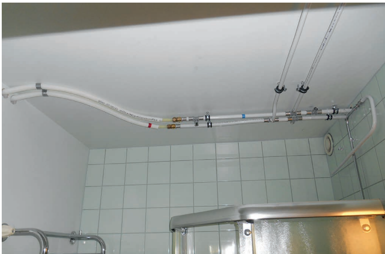
Hybridiratkaisussa uudet käyttövesiputket jäävät kylpyhuoneessa alasasketun katon alle piiloon.
