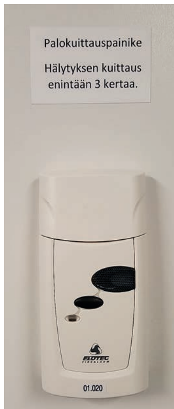
ElotecniQ-kuittauspainike asunnossa. Sisäisen hälytysajan pituutta ja kuittauksien enimmäismäärää voidaan säätää.
