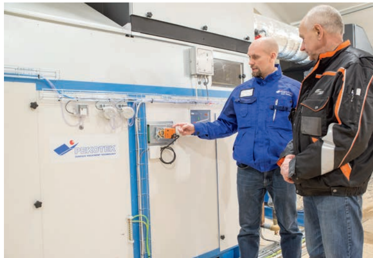
Petri Rautiainen ja Nordautomation Oy:n tuotantojohtaja Tenho Saarimaa tutkivat lämmöntalteenottolaitetta. ”Pekotekin pintakäsittelyjärjestelmän asennus sujui projektina joustavasti ja nopeasti”, Saarimaa kertoo.
