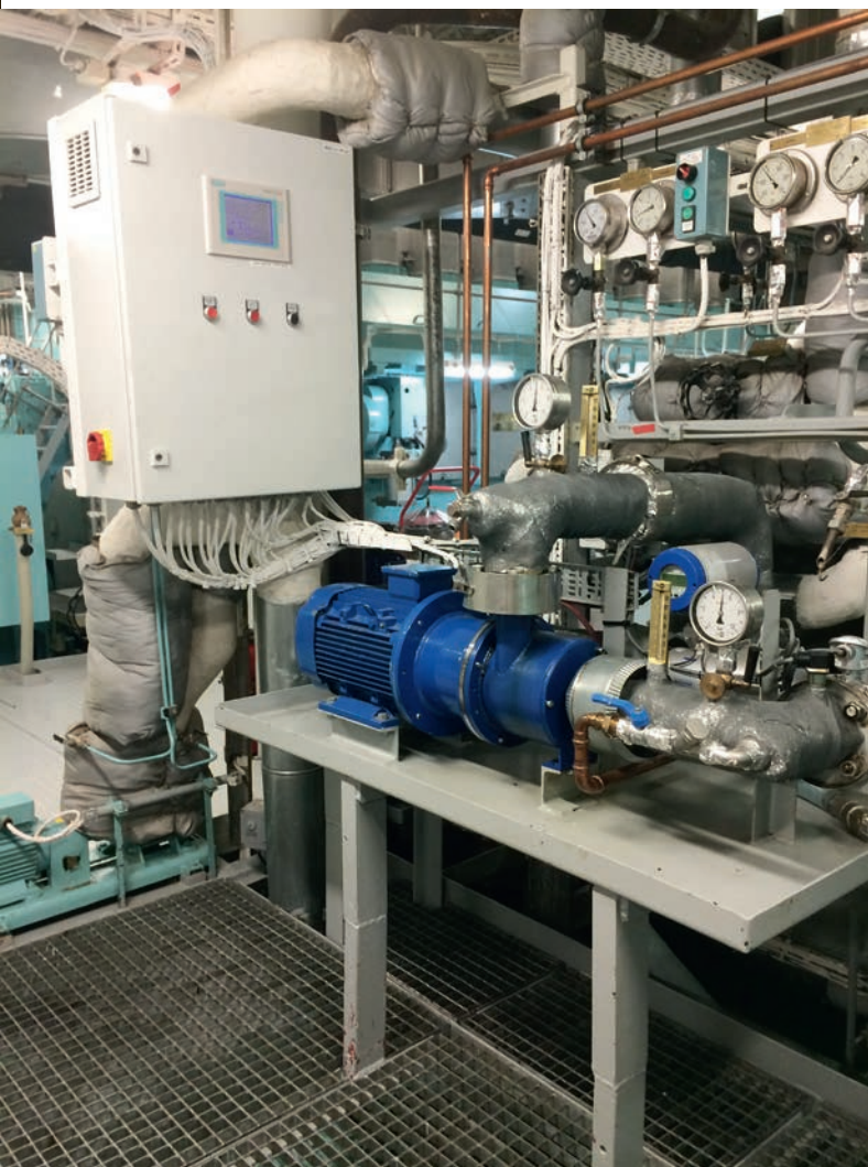
Homogenisaattori asennettuna polttoainejärjestelmään.
