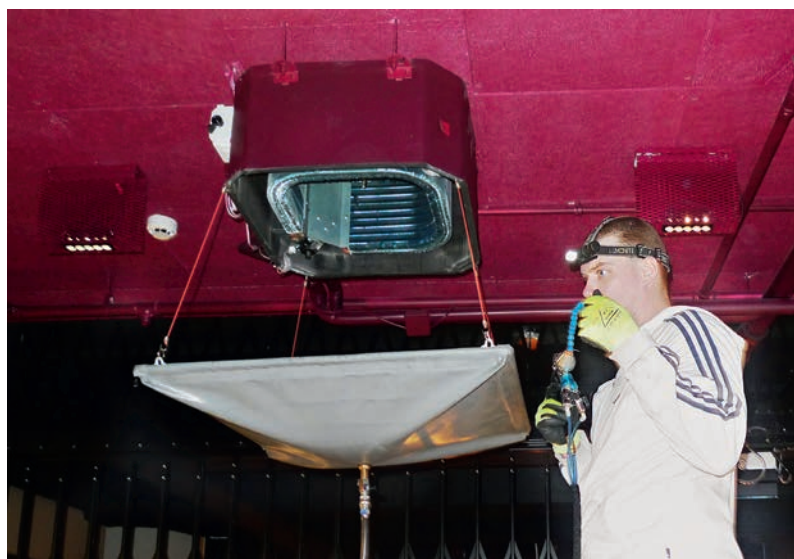
Teamtech Oy:n asentaja Ville-Pekka Niemelä puhdistaa kauppakeskuksen puhallinkonvektoria. Pestävän kohteen alle asetetaan suojakaukalo, johon likavesi kerätään.
