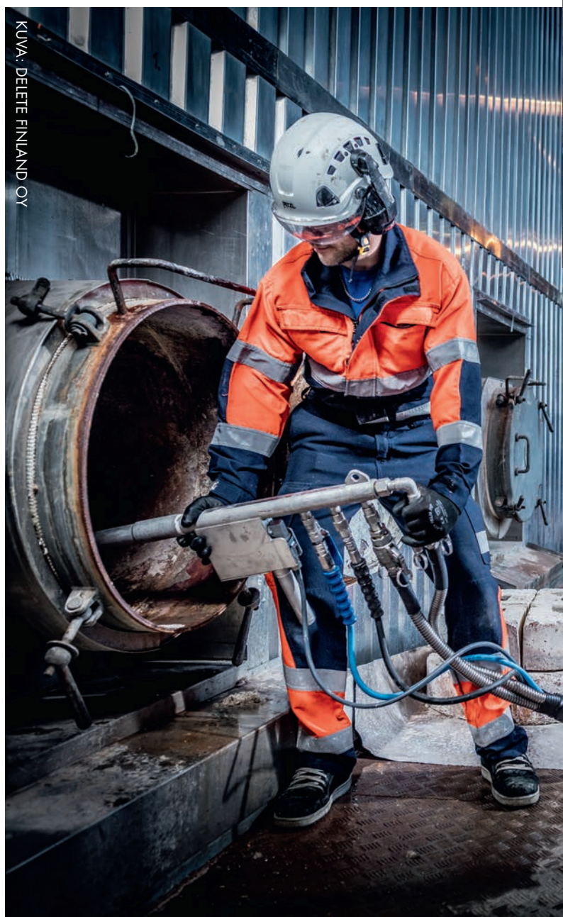
Räjätyspuhdistukselle tyypillisiä käyttökohteita ovat erilaiset polttokattilat, sähkösuotimet ja siilot.
