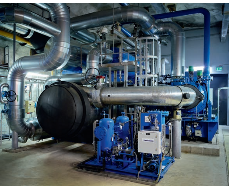
Katri Valan lämpöpumpulaitos.
