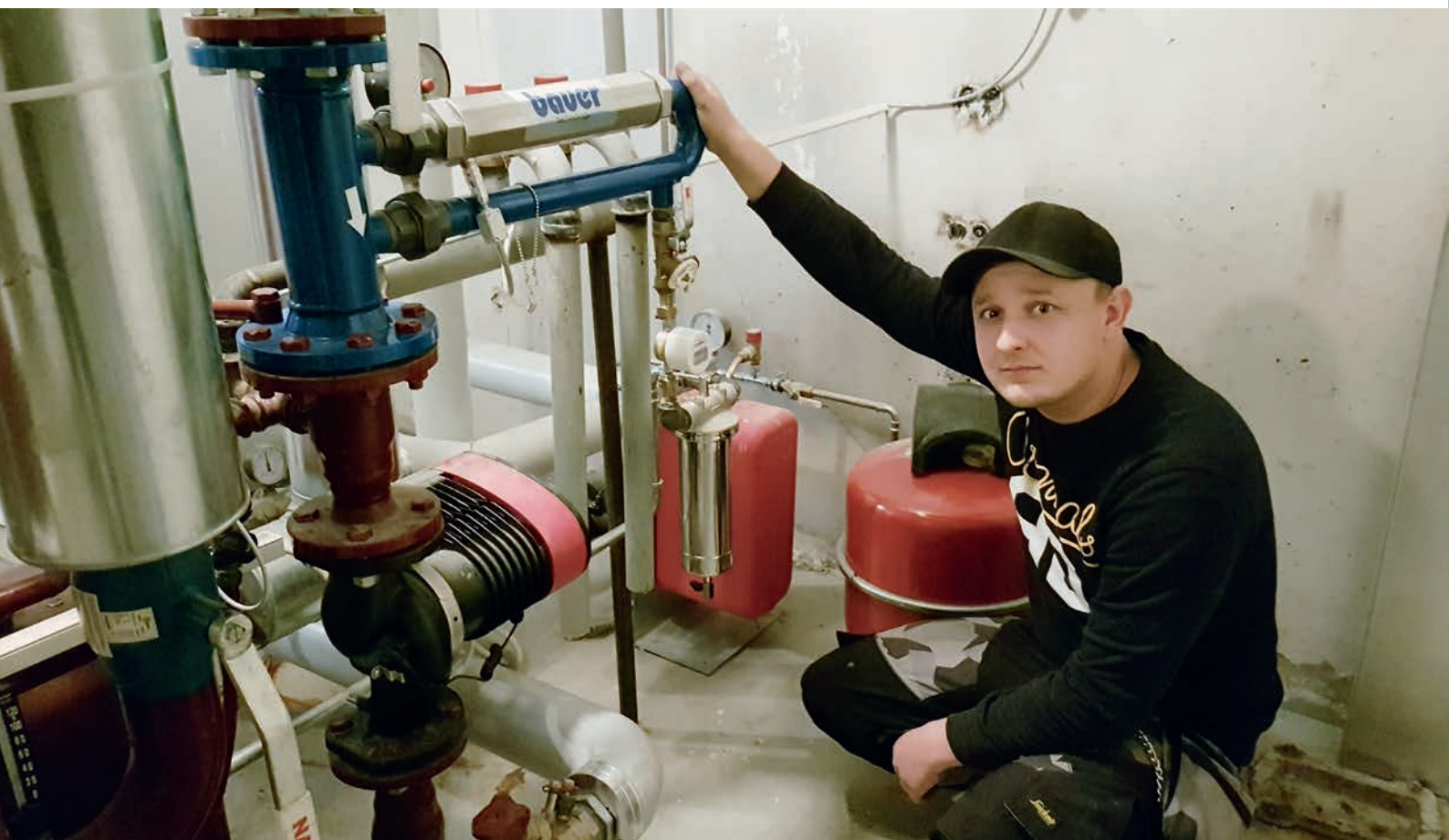
Kuvassa on kiinteistönhoitaja Lauri Vilmunen Etelä-Pohjanmaan Kiinteistöhuolto Oy:stä, joka on Ylisenhaan kiinteistönhoitoyhtiö. Lauri on vaihdellut taloyhtiössä Bauerin vedenkäsittelylaitteen suodattimia.
