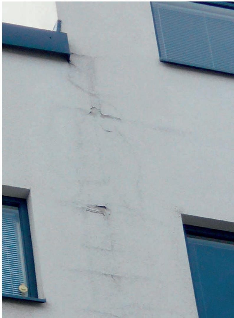
Kuvassa halkeilua ja pakkasrapautumista ohutrappaus-eristejärjestelmän rappauskerroksessa.
