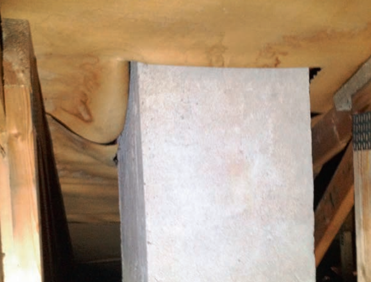
Savupiiput ym. läpiviennit ovat vuodoille riskialttiita kohtia yläpohjassa.
