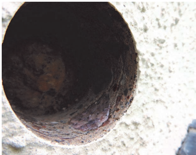
Pakkasrapautumisesta halkeillut julkisivuelementin ulkokuori.
