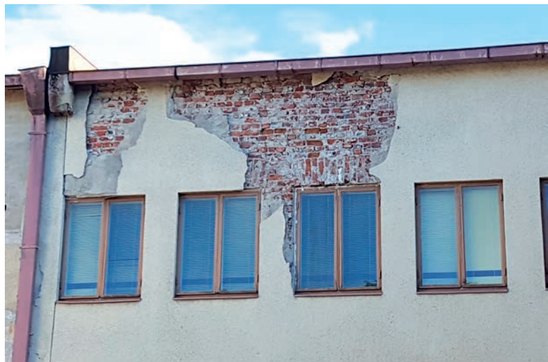
Rapautunutta rappaus- ja muurauslaastia räystäään alla.
