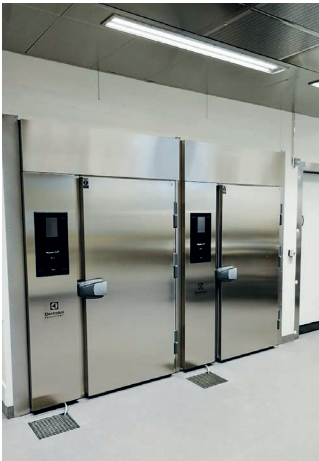
Tehokkaat jäähdytyshuoneet keittiössä.
