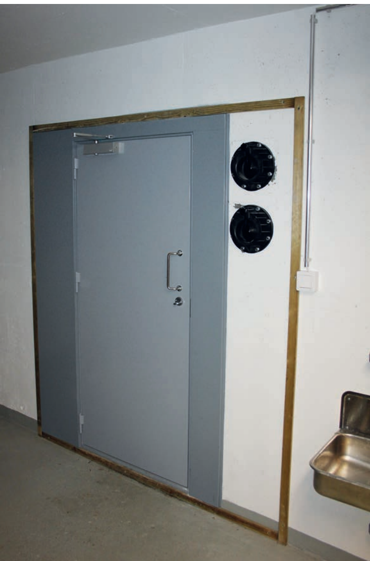
Väestönsuojan oviaukkoon asennettu sulkuteltan kehys ja ylipaineventtiilit.
