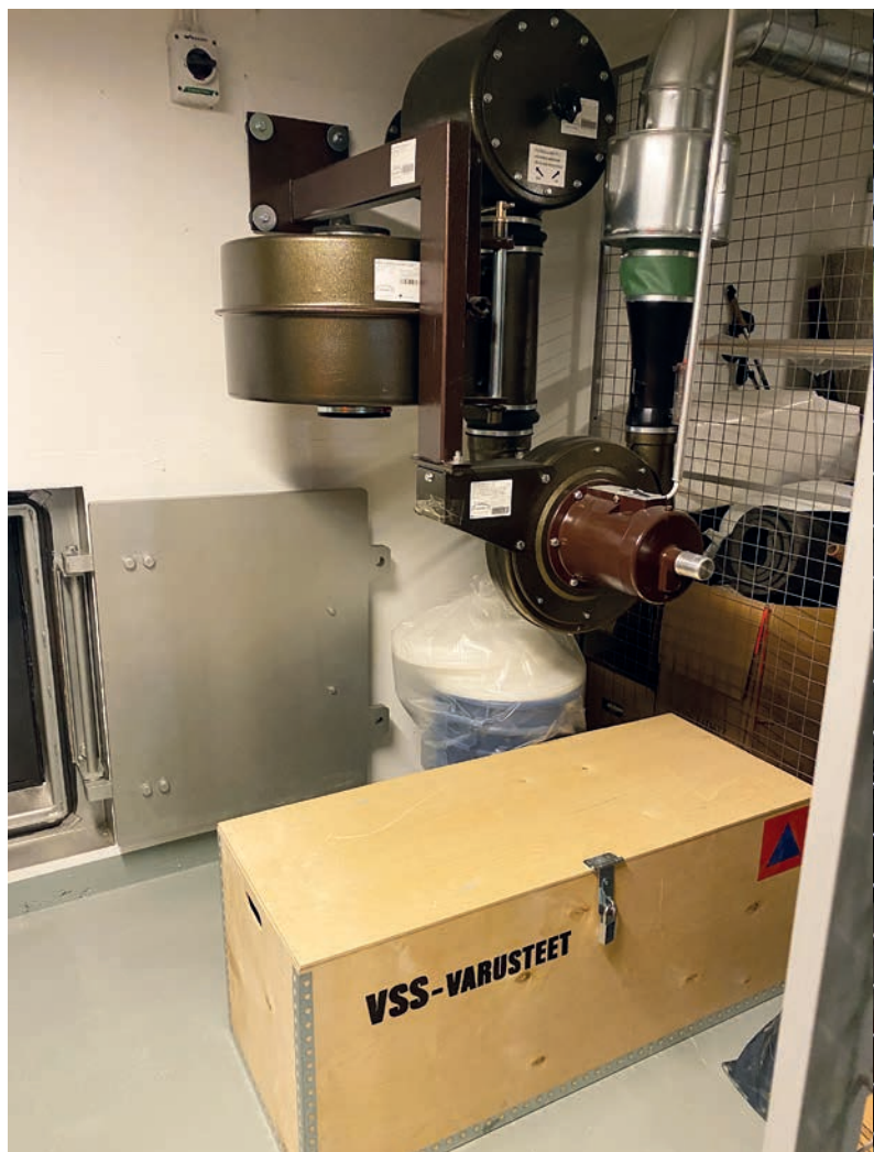
Väestönsuojan varustelaatikko ja suojapuhallin.
