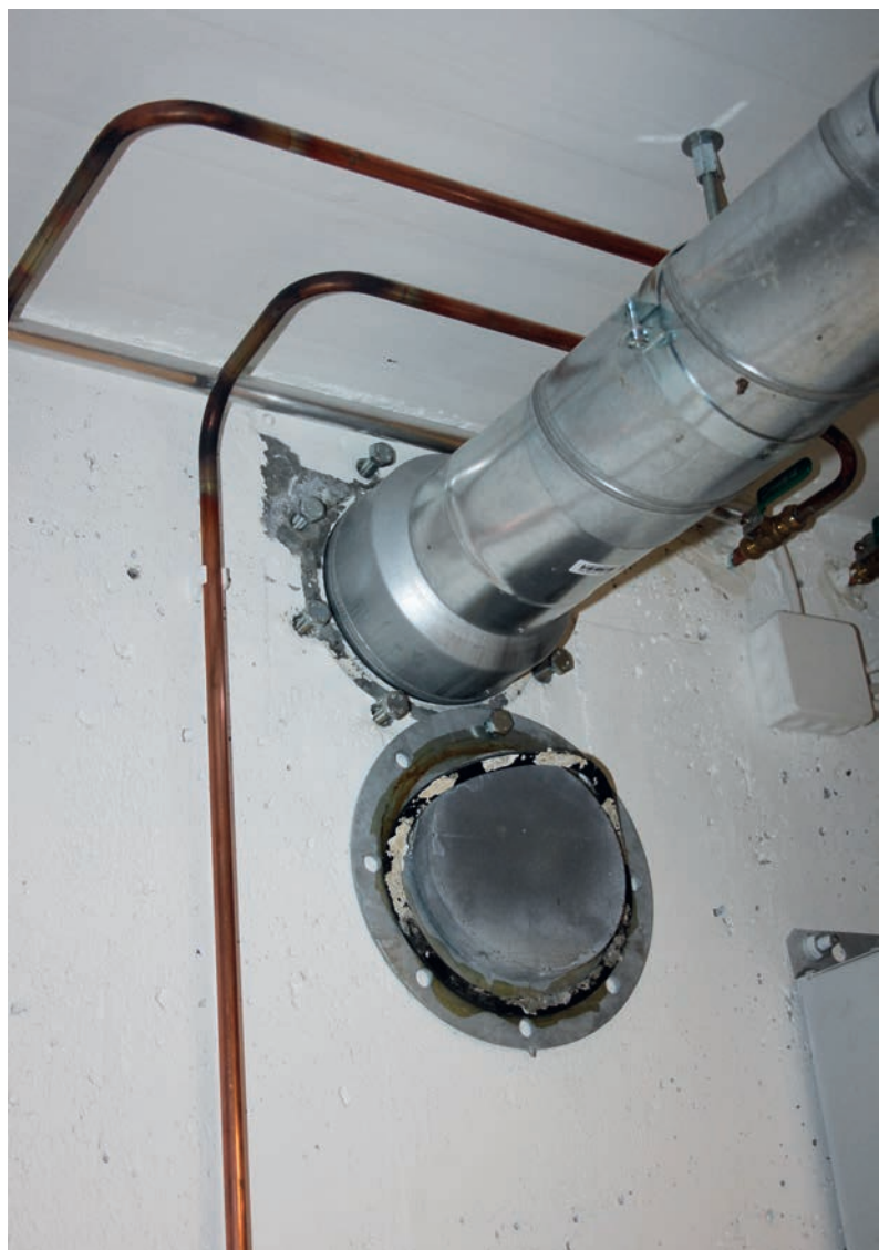
Ilmanvaihdon sulkulaippa. Tiiviste on irronnut ja maalissa.
