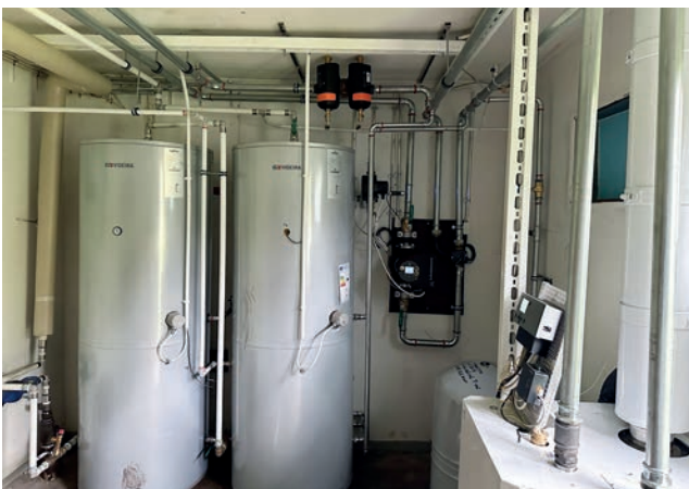
11 asunnon rivitalokohde lämpenee jatkossa GEBO:n toimittamalla lämmitysjärjestelmällä. Pienikokoinen 64 kW ekokattila, kaksi 500 litran varaajaa ja fiksu automatiikka takaavat säästöt sekä varman lämmön, myös paukkupakkasilla.
