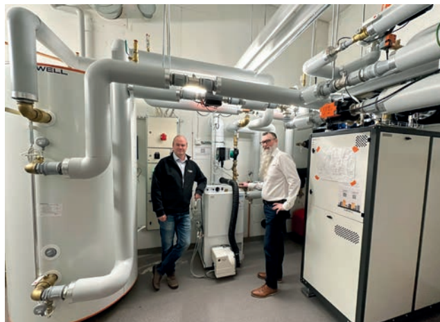
GEBO:n toimittama 64 kilowattinen HVO-kattila on asennettu huipputehoa varten osaksi hybridilämmitysjärjestelmää. Asiantuntijat John Morelius (vas.) ja Johan Karlstedt GEBO Finland Oy:stä pohtivat, että kattila on myös huoltovarmuustekijä. Häiriötilanteessa huipputehokattilan teho riittää koko kiinteistön lämmittämiseen.
