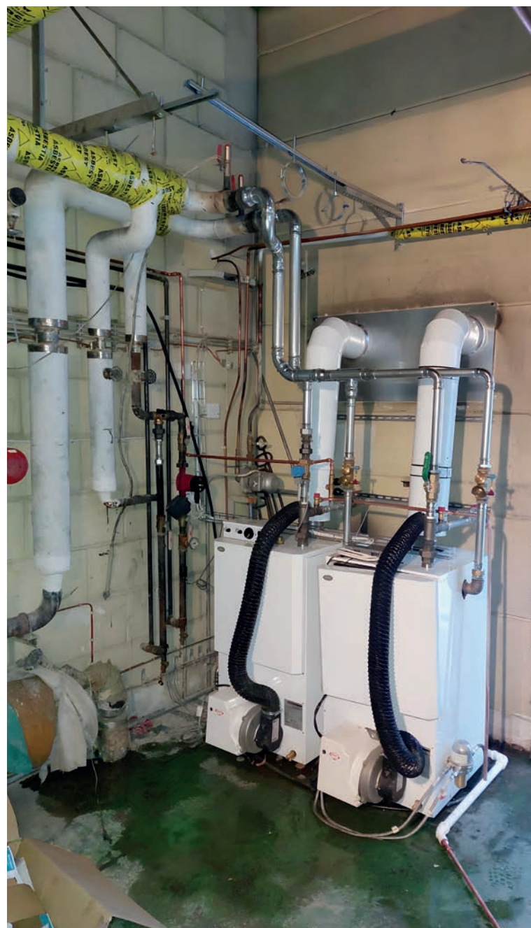
GEBO:n kaksi 52 kW HVO-kattilaa tulee lämmittämään isoa varastoa, kun asennus on viety loppuun.
