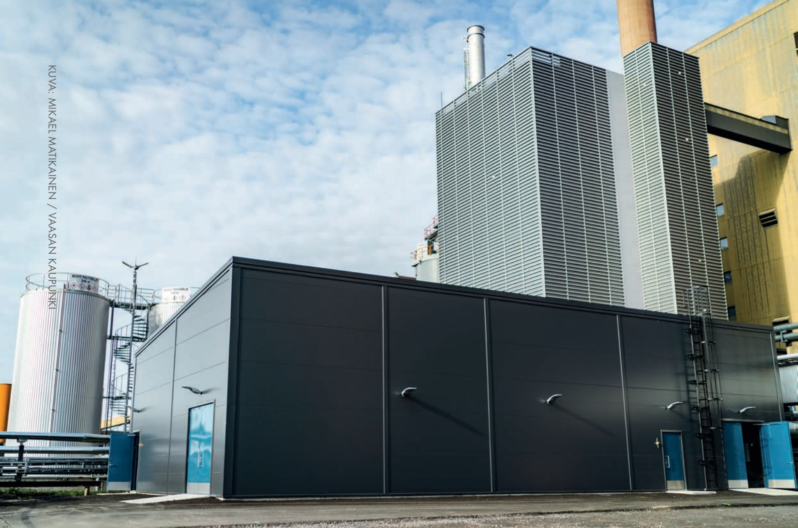
Vaasan Vaskiluodon vuonna 2020 käyttöön otettu suuri lämpöenergiavarasto.
