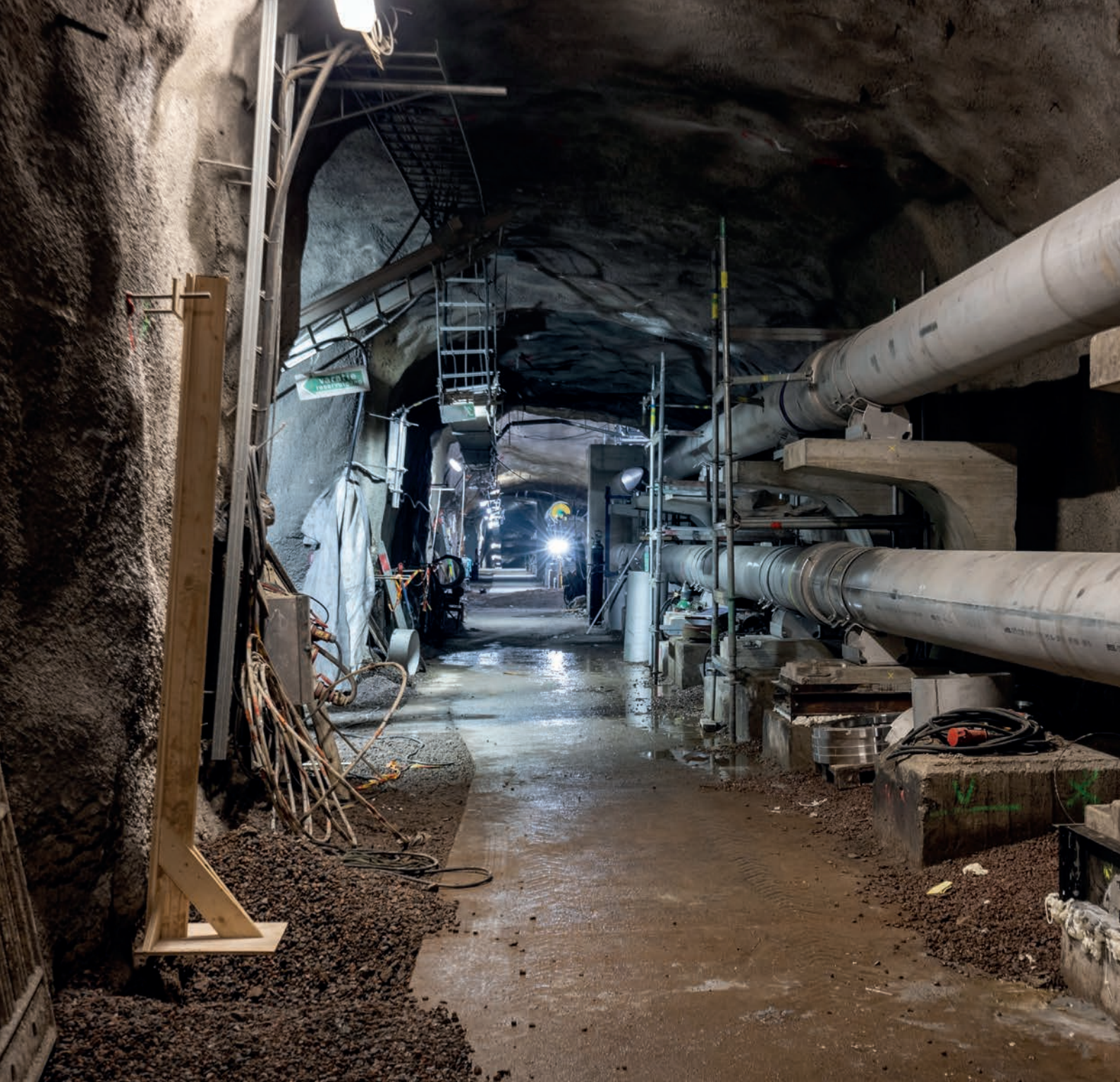
Helsingin Mustikkamaan lämpöluolavarasto.
