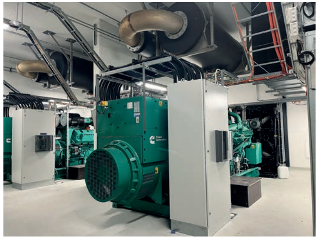
Varavoimakoneet asennettuna varavoimahuoneeseen.
